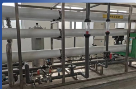
天方药业中水回用设施
